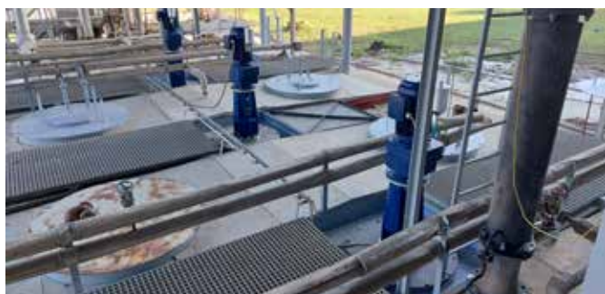
Vgrajena nova mešala EKATO na nevtralizacijskem bazenu.
