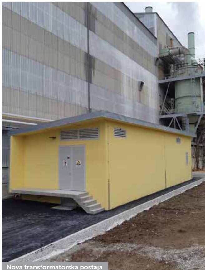
Nova transformatorska postaja
