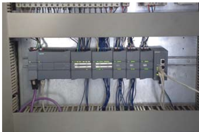
Novo krmiljenje s krmilnikom Siemens Simatic S7 1200
