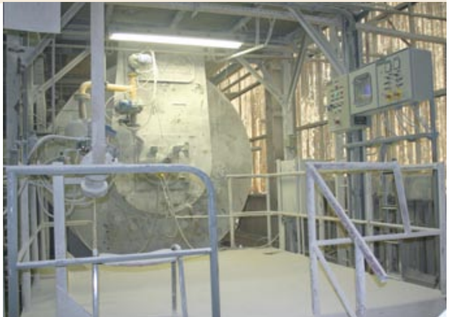
Novo stanje opreme na gorilniku peči
