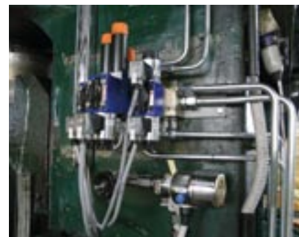
Vgrajena hidravlična oprema
