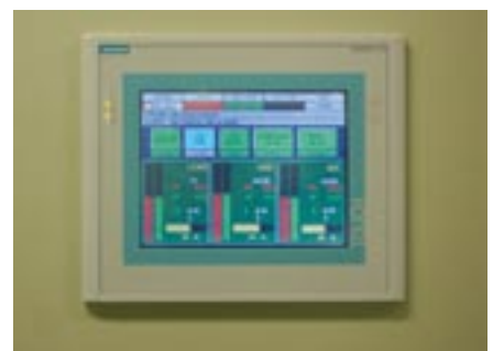
Krmiljenje gorilnika kalcinacijske peči
