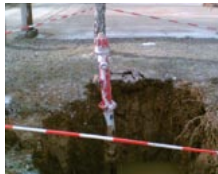
Defekt hidranta pri nevalizaciji
