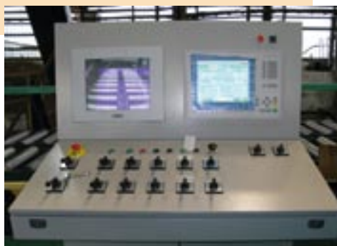
Del elektro opreme in nov krmilni pult
