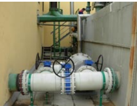
Zunanji sesalni koš in by-pas za ohlajeno vodo
