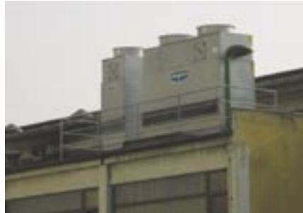
Hladilna stolpa za hlajenje valjarne
