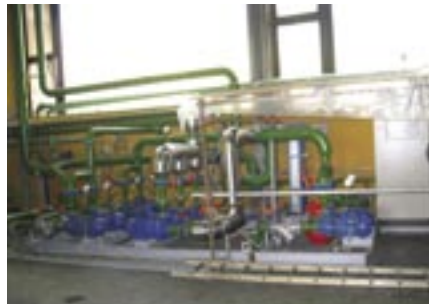
Notranji sistem hlajenja valjarne
