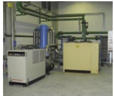
Hladilniška sušilnika in vodni hladilni sistem
