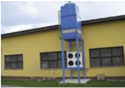
Hladilni stolp in hladilni agregat za hlajenje žice
