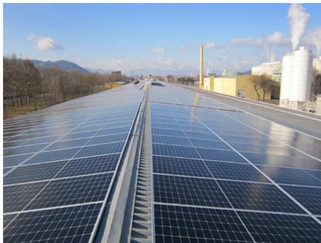
Sončna elektrarna, nameščena na stavbi Valjarna. Instalirana moč 999,8 kWp, predvidena proizvodnja 1.099,78 MWh.
